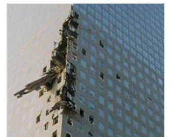
Figure 6: Element de structure de la Tour Nord planté dans le World Financial Center 3
